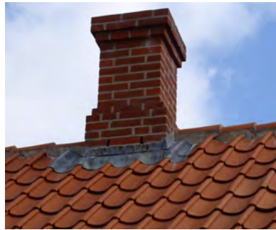
Forhuskorsten. Ribepibe med synlig blyinddækning.
