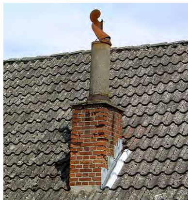
Baghus/Sidehuskorsten på tagside.
